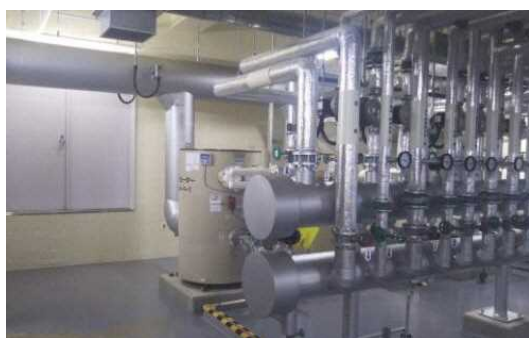
【余裕のある機械室（岩内町役場）】
